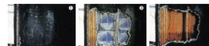
石膏ボードが炭化。石膏ボード下には火は回っていません。構造材に火災の影響はまったくありませんでした。
